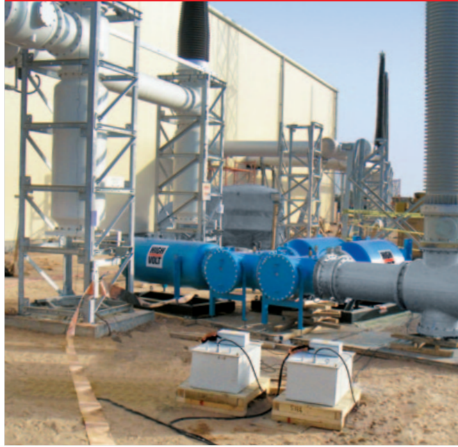
Fig. 1 Système d'essai résonant AC de type WRVG G pour un essai de GIS/GIL sur site
