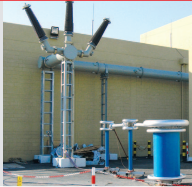
Fig. 2 Système d'essai résonant AC de type WRV M pour un essai de GIS/GIL sur site
