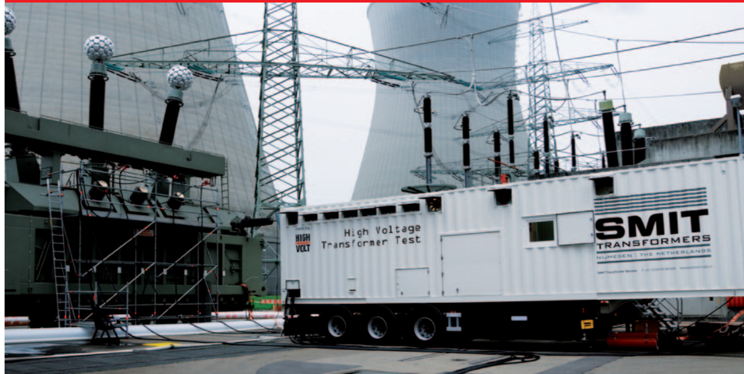
Fig. 1 Teste de transformadores no campo de uma unidade de 1100 MVA em usina nuclear
