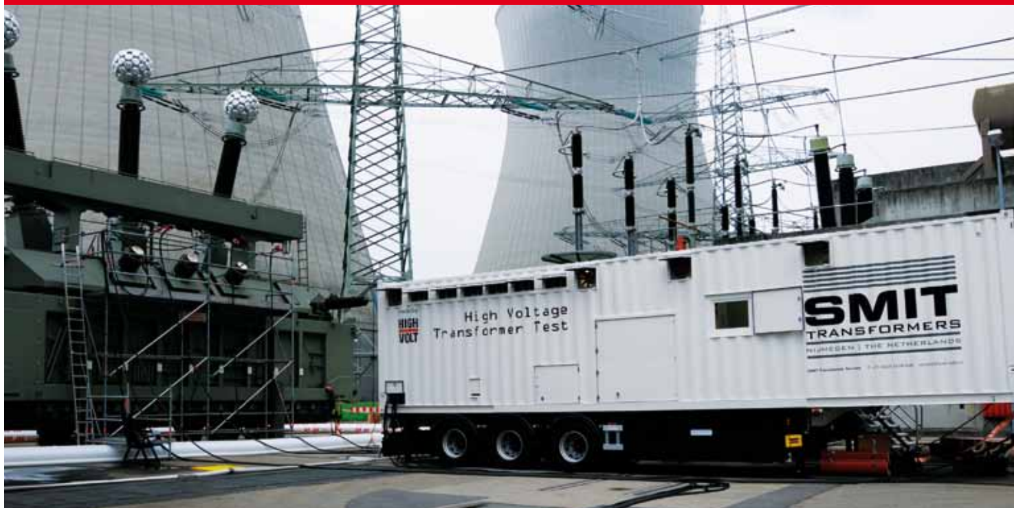
Рис. 1 Тестирование трансформатора 1100 МВА на блоке атомной электростанции
