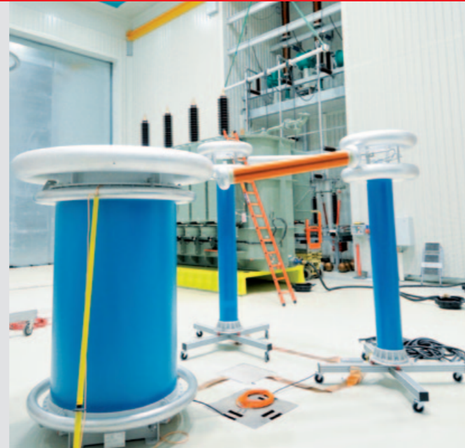
Fig. 2 Système d'essai de tension appliquée pour le test de transformateurs de puissance, type WRV 5/360 M
