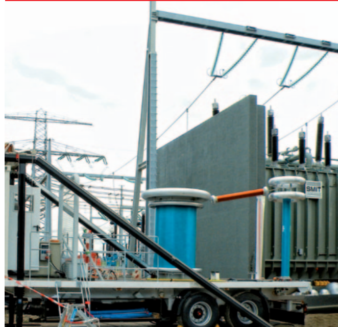
Fig. 1 Système d'essai de tension appliquée pour le test sur site de transformateurs de puissance, type WRV 5/360 M
