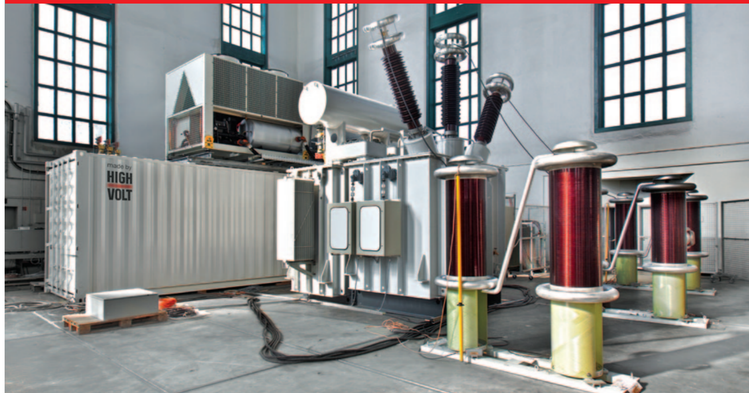
Fig. 1 Système d'essai pour transformateur pour des essais de tension induite, basé sur un convertisseur de fréquence statique, type WV 2000-4000/170
