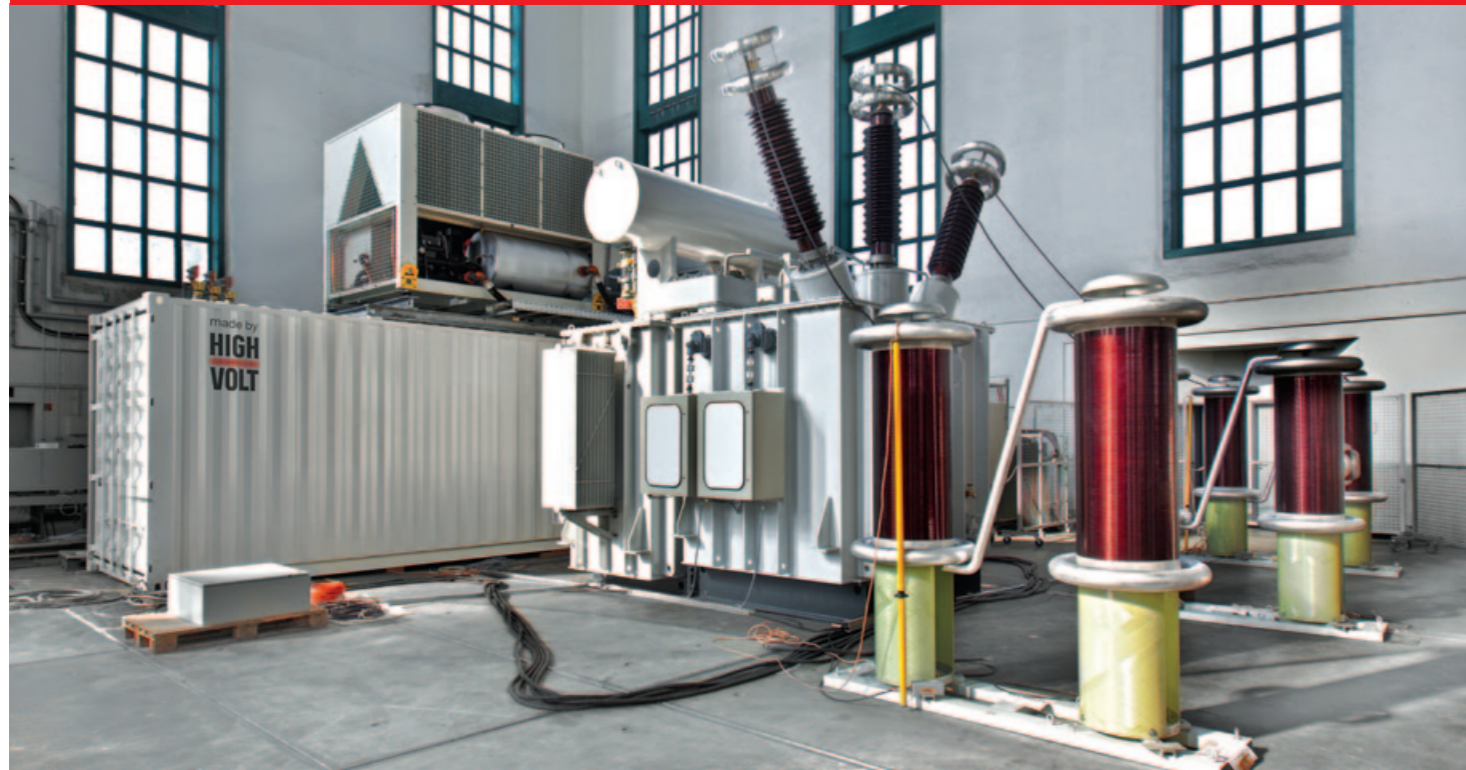
Fig. 1 Sistema de ensayo para transformadores, ensayos de tensión inducida, teniendo como base un convertidor de frecuencia estático, modelo WV 2000-4000/170
