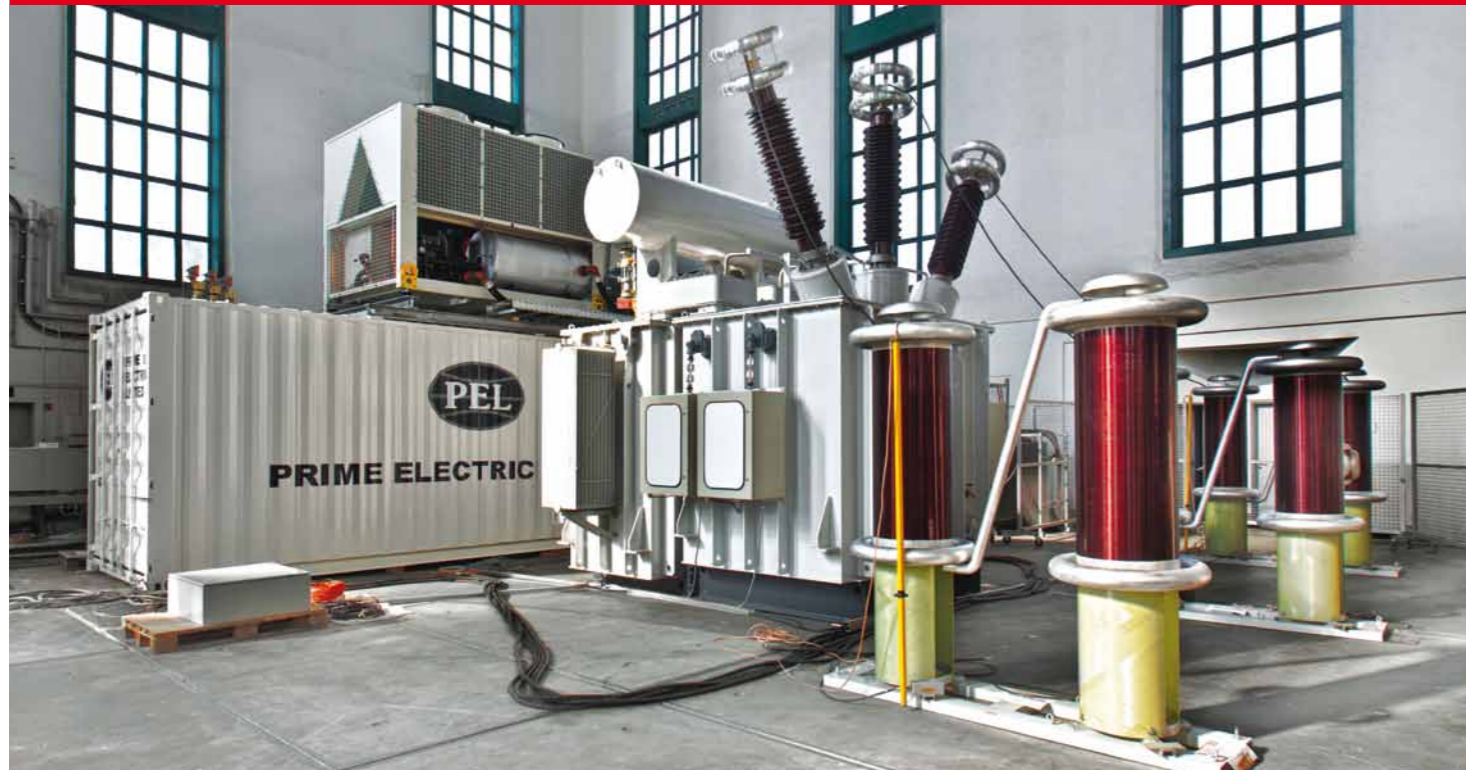
Рис. 1 Система испытаний трансформаторов для испытаний индуцированным напряжением на основе статического преобразователя частоты, тип WV 2000-4000/170
