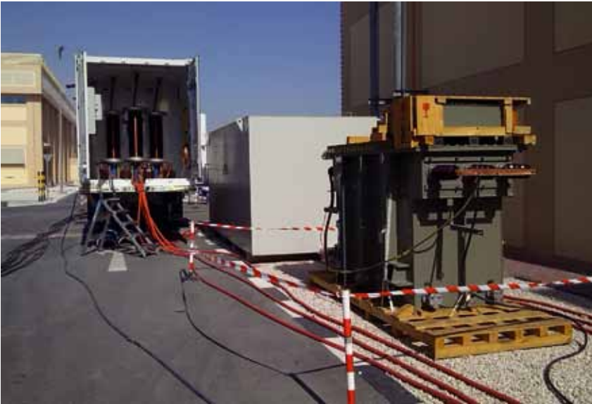
Bild 2. Teilentladungsmessung an einem 800-MVA-Transformator mit 1,7 \cdot U_n (714 kV); links: der geöffnete Trailer des Prüfsystems; rechts: der Kompensationsreaktor
