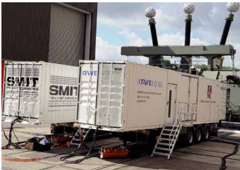
Bild 1. Seit Jahren im Einsatz – Vor-Ort-Prüfsysteme der Highvolt Prüftechnik Dresden
