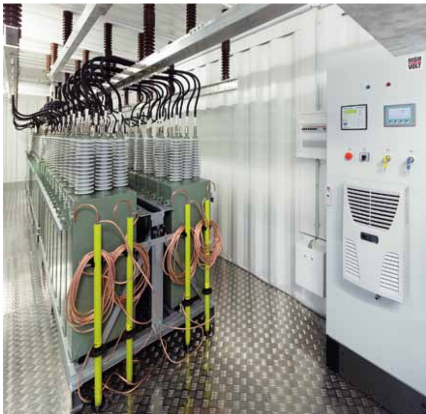
Bild 6. Innenraum einer mobilen Kondensatorbank, ausgestattet mit Schutz- und Sicherheitstechnik
