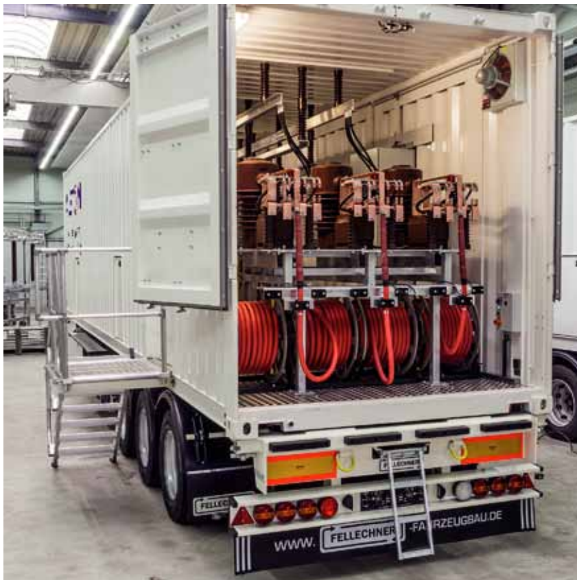
Bild 5. Mobile Kondensatorbank einschließlich Präzisionsstromwandlermesssystem
